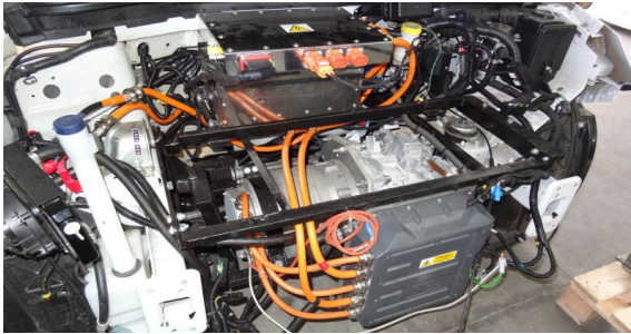
Rys. 3. Falownik Sevcon Gen4Size8 zamontowany w samochodzie osobowym, za nim widoczny silnik IPMSM i skrzynia biegów
